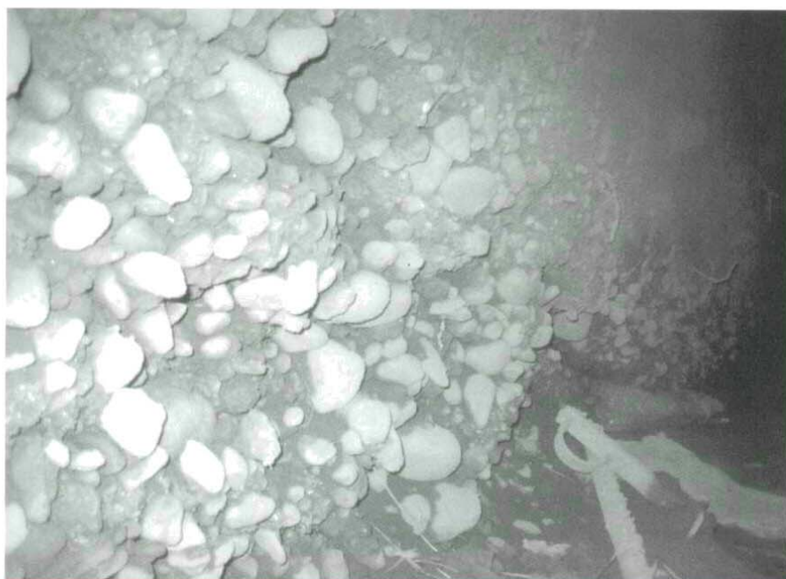
Коррозия бетона фундамента
