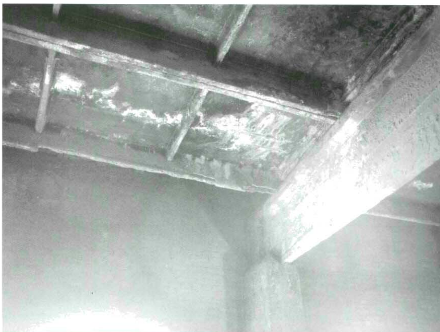
Коррозия бетона фундамента
