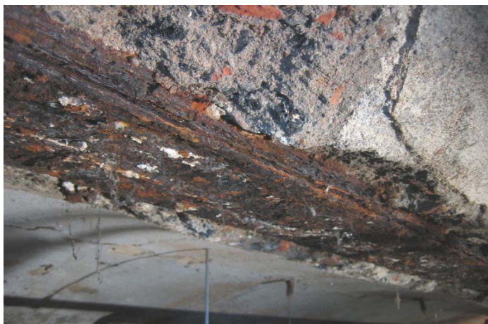
Рис.1 Корродированная балка перекрытия
