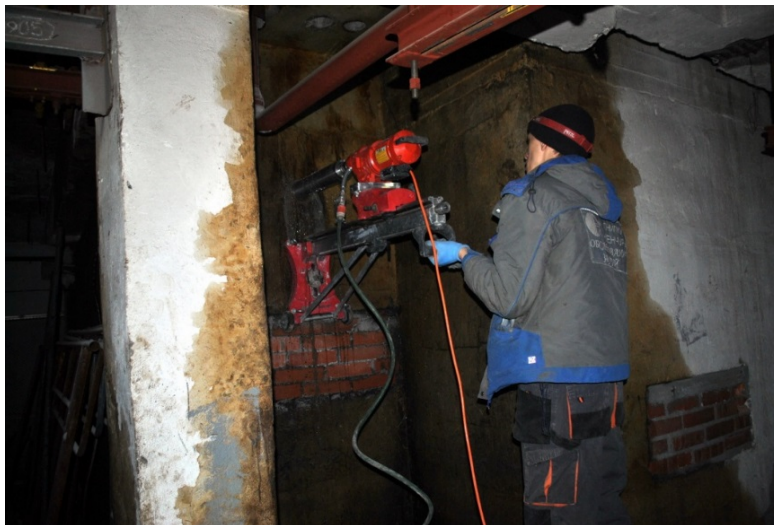
Рисунок 4 – Отбор кернов из фундаментов компрессоров. Следы промасливания на поверхности фундаментов и колонн
