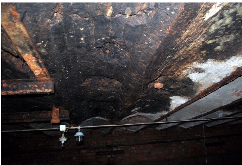
Рисунок 3 – Промасливание бетона сводиков балочного перекрытия
