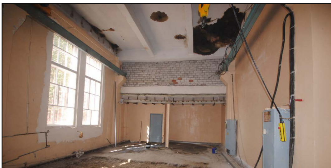
Рисунок 1 – Пятна промасливания на монолитном ребристом перекрытии завода
