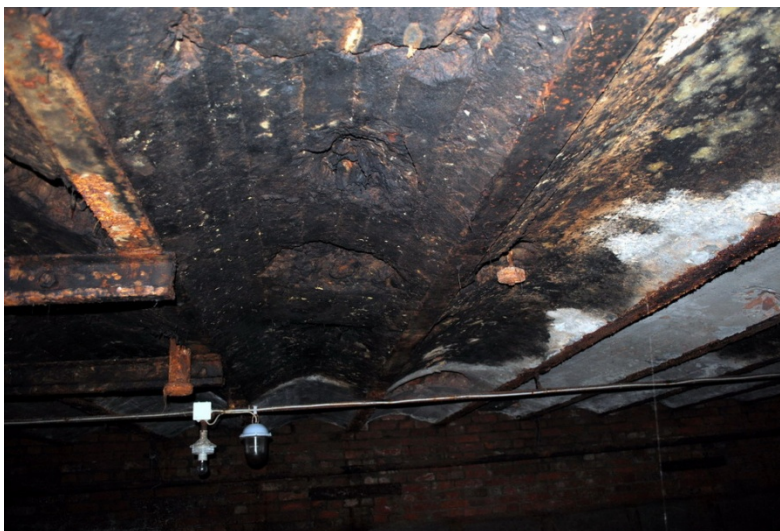
Рисунок 3 – Промасливание бетона сводиков балочного перекрытия
