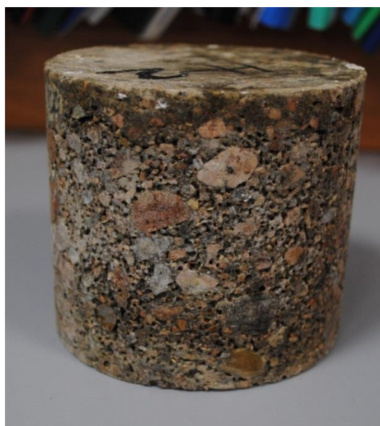
Рисунок 5 – Образец промасленного бетона. Структура бетона с большим количеством пор
