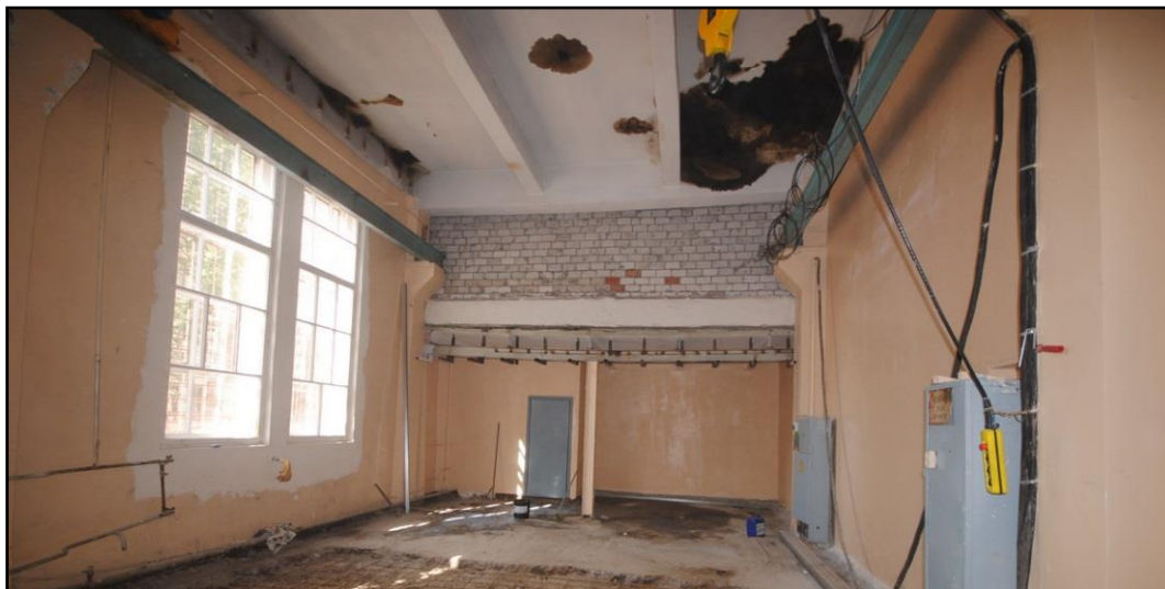
Рисунок 1 – Пятна промасливания на монолитном ребристом перекрытии завода
